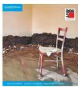
Für instandsetzungsfähige Hochwasserschäden im Innenbereich
