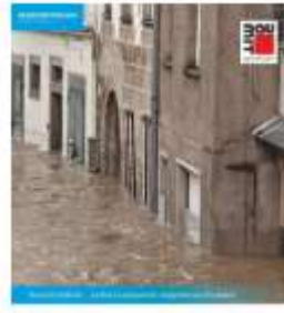
Für instandsetzungsfähige Hochwasserschäden an der Fassade
